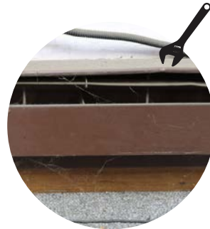
Problème de chauffage
