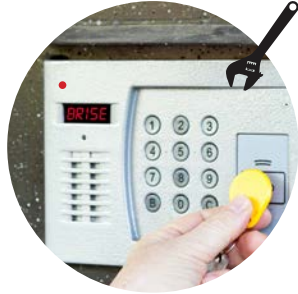
L'intercom est en panne
